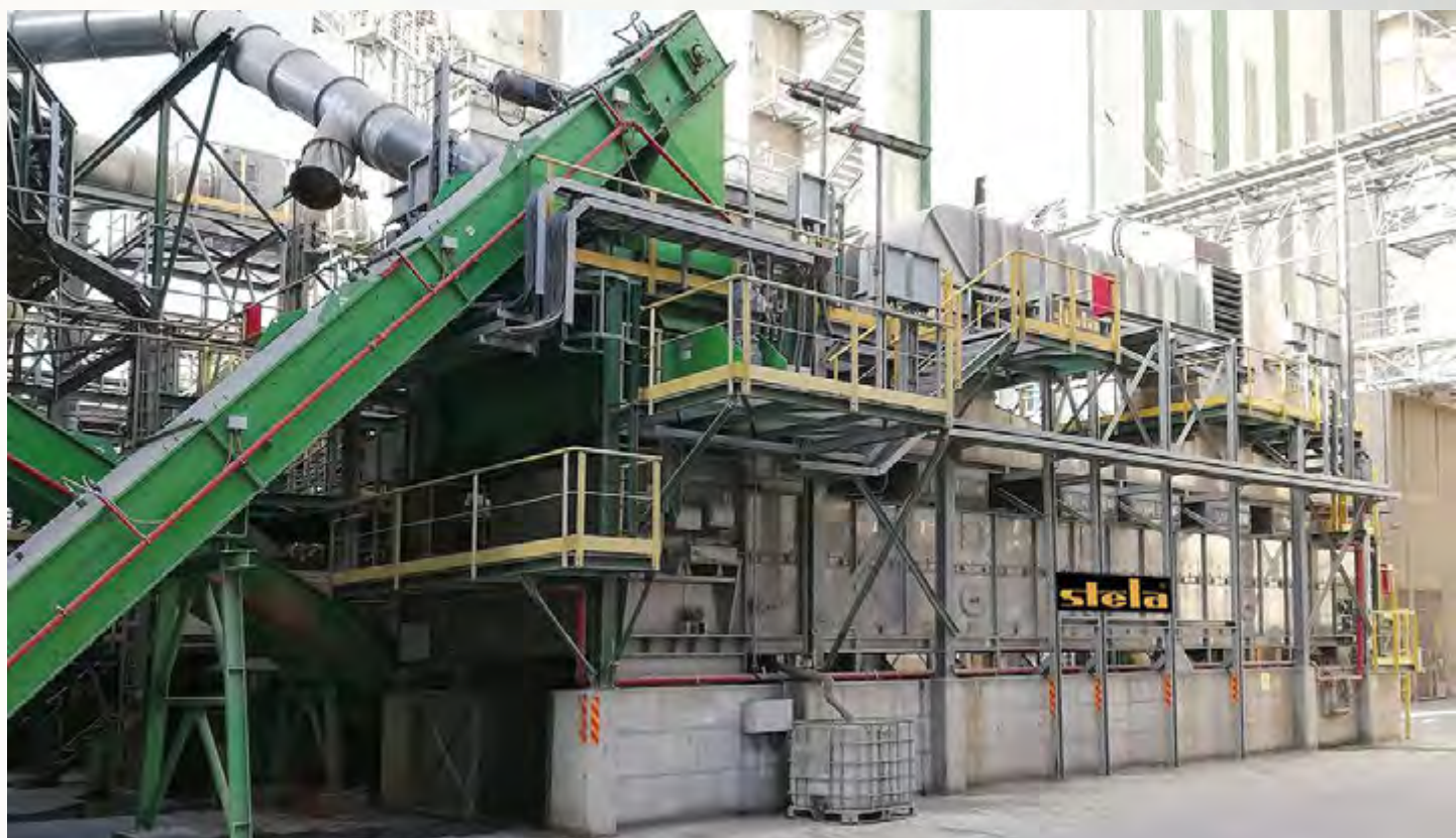
项目地：Nesher Israel 水泥，以色列 | 型号：BTLU 1/3000-16 | 安装年份：2018 干燥物料：RDF垃圾燃料 | 蒸发量：最大1.1吨/小时
