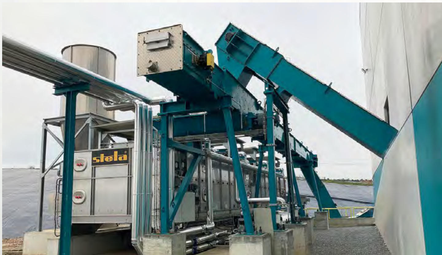
项目地：Ecobeirao, 葡萄牙 | 型号：BTL 1/3000-14 | 安装年份：2023 干燥物料：SRF固体回收燃料 | 出料能力：约3.0吨/小时 | 降水区间：65% - 47%湿度
