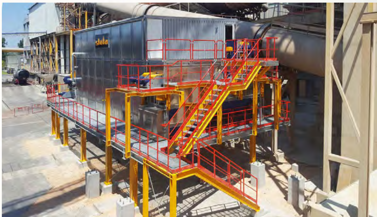
项目地：Cimpor，葡萄牙 | 型号：BT 1/6200-12 | 安装年份：2016 干燥物料：RDF垃圾燃料 | 出料能力：约7.0吨/小时 | 降水区间：40% - 15%湿度
