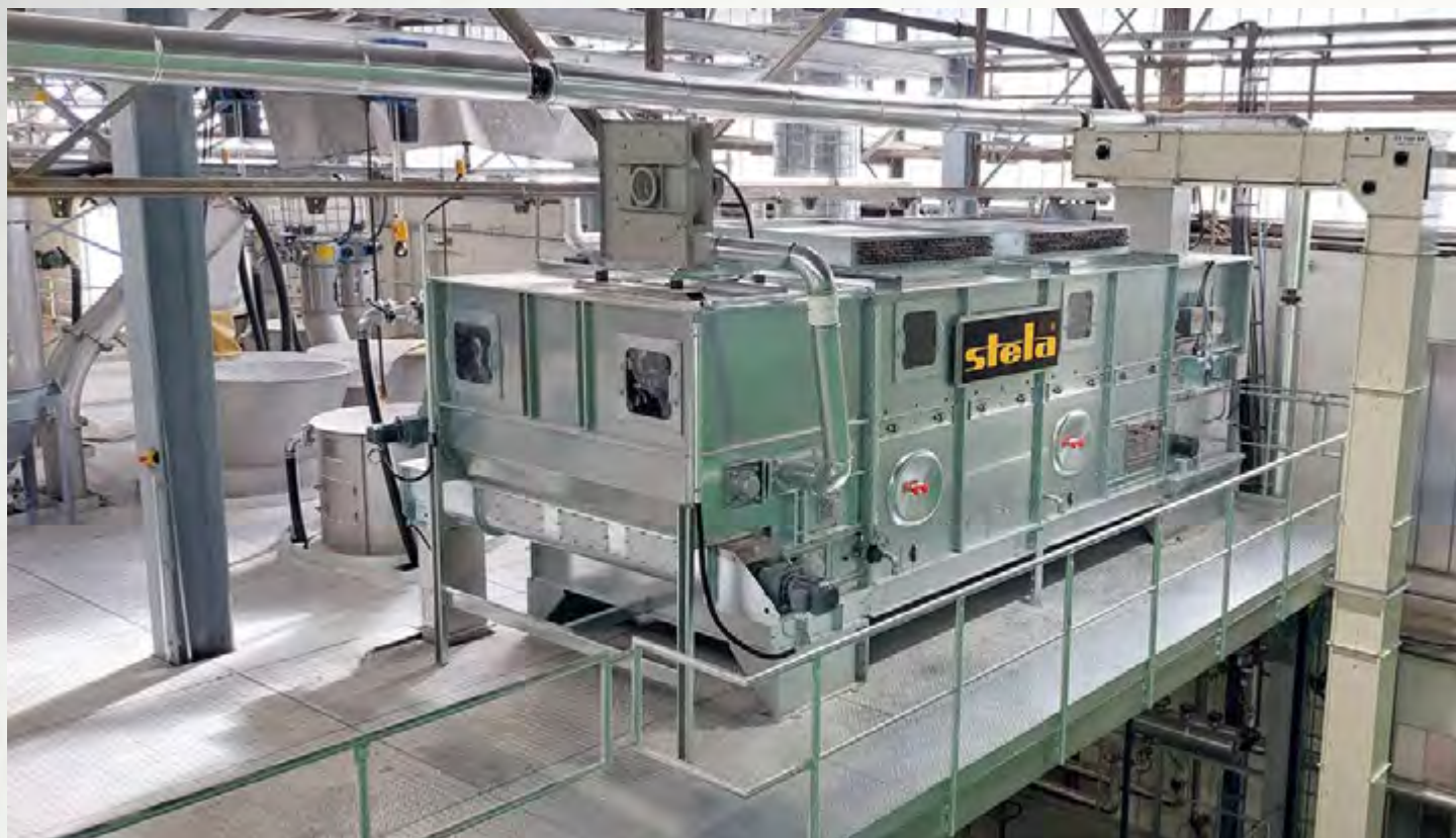
项目地：Akdeniz Chemson, 葡萄牙 | 型号：BTL 1/2000-4 | 安装年份：2023 干燥物料：颗粒塑料 | 出料能力：约2.27吨/小时 | 降水区间：10% - <1%湿度
